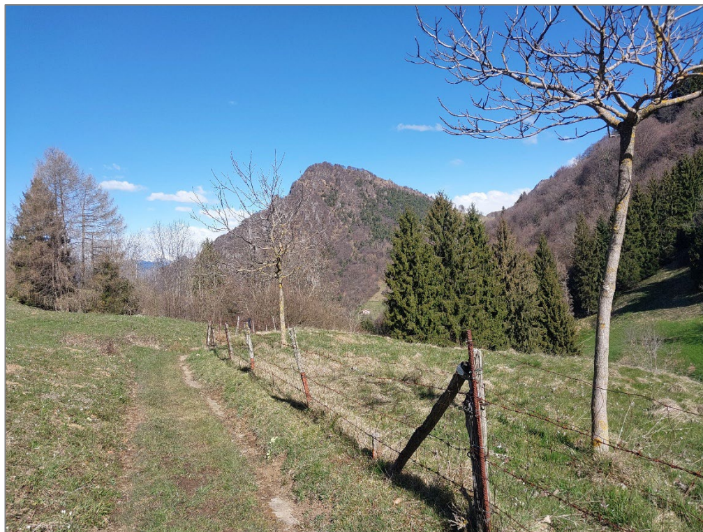
Figura 3 – Tratto 1C – 1D – Realizzazione ricarica piano viario esistente in spaccato di cava
