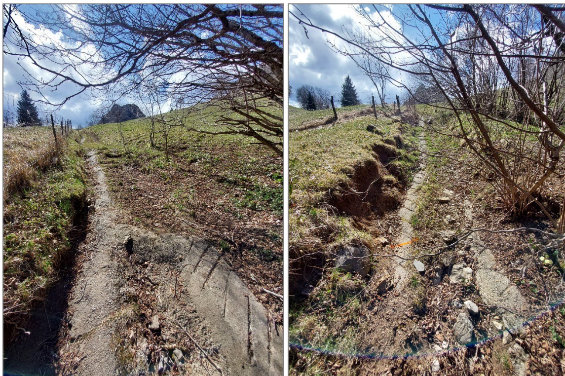
Figura 5 – Tratto 1D – 1E – Demolizione pavimentazione esistente e realizzazione nuova pavimentazione in cls, con riprofilatura scarpate
