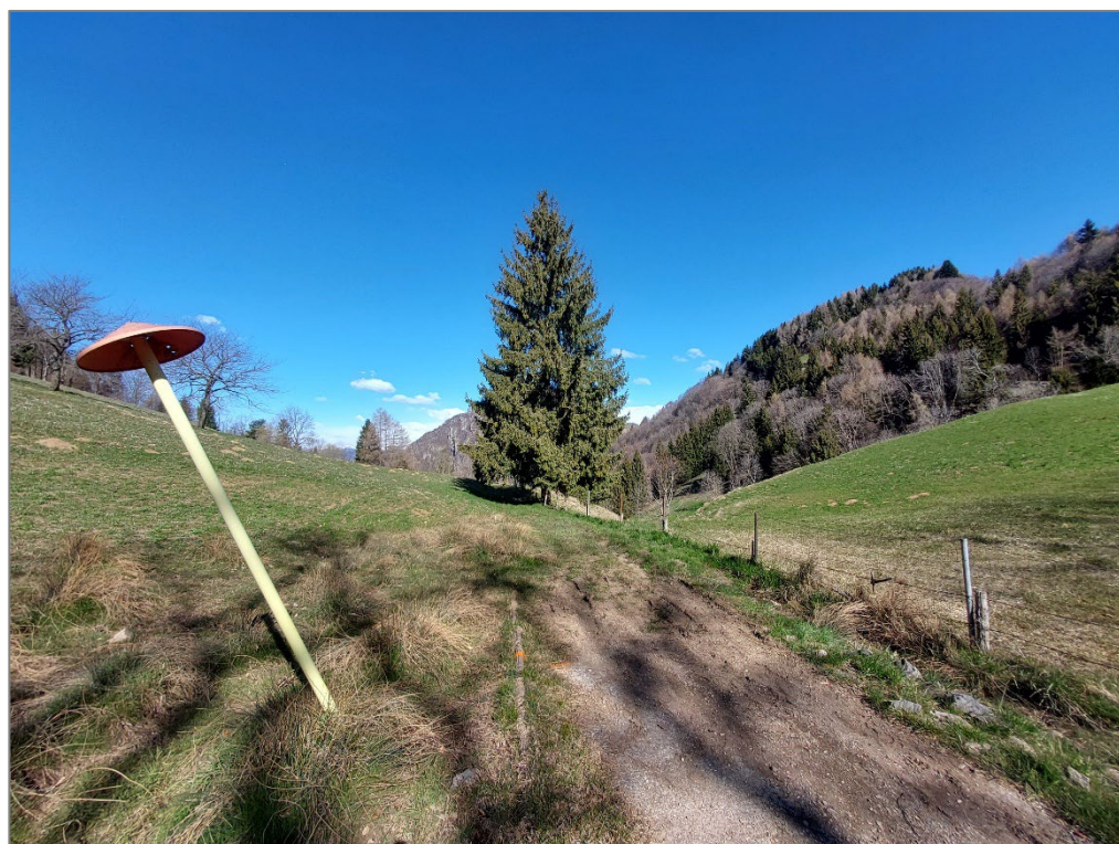
Figura 2 – Tratto 1C – 1D – Realizzazione ricarica piano viario esistente in spaccato di cava
