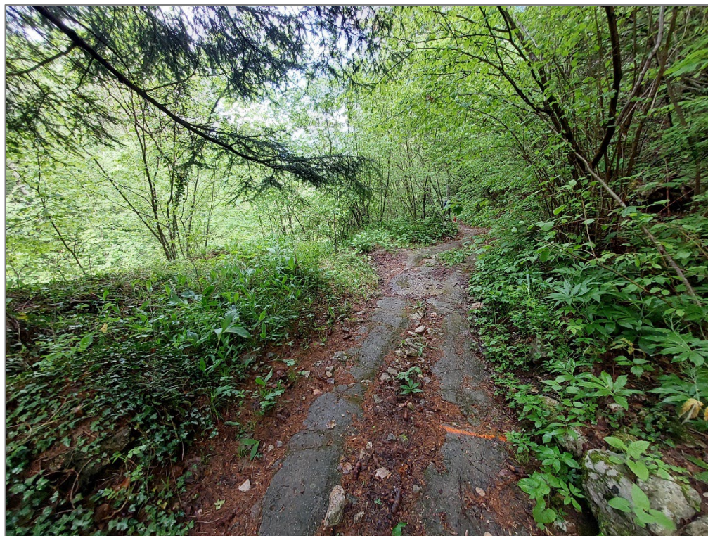
Figura 15 – Tratto 1G – 1L – Demolizione pavimentazione esistente e realizzazione nuova pavimentazione in cls
